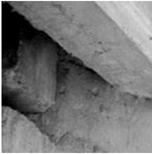
Figura 1. Grietas por falta de capacidad de carga de las aletas. Puente Venecia.
