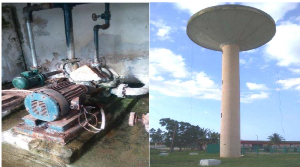
Figura 2. Motor y tanque de almacenamiento del sistema de abastecimiento.
