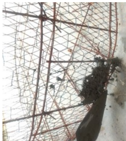
Figura 2. Detalle de la estructura de ferrocemento donde se realizaron las pruebas de embarrado.
